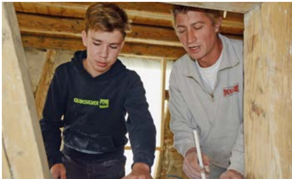
Polier Adrian Peter zeigte dem Schüler Maximilian Füchtenbusch wie eine Gipsplatte fachmännisch im Fachwerk befestigt wird.
